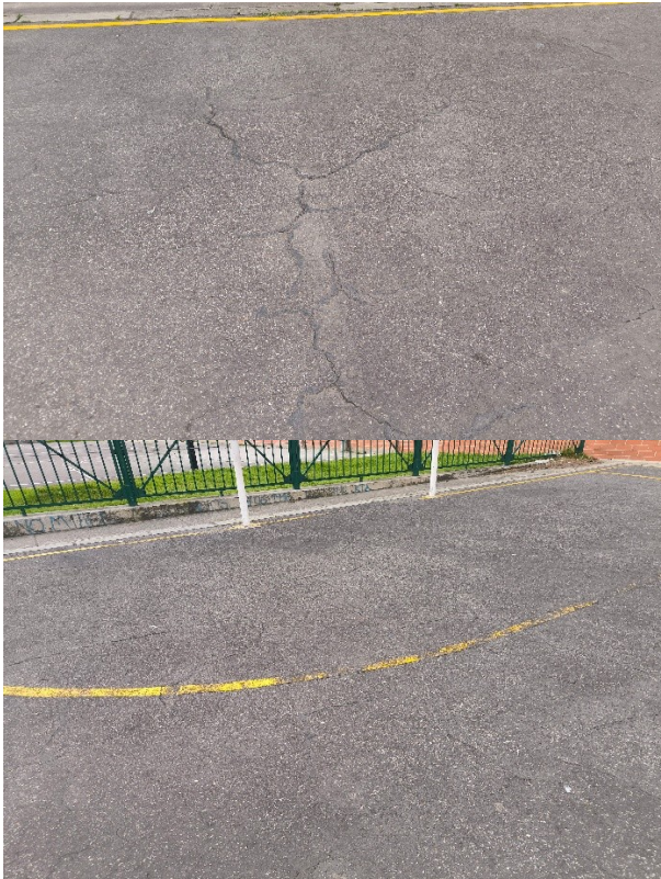
Fotografía 13 – Agrietamiento Cancha MICROFUTBOL
