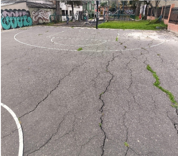
Fotografía 5 – Agrietamiento Cancha BALONCESTO
