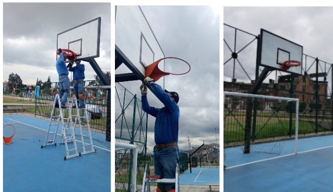
Imagen 1. Evidencias del mantenimiento de los aros en la cancha de baloncesto Parque Zonal Gilma Jiménez febrero 19/2026.
